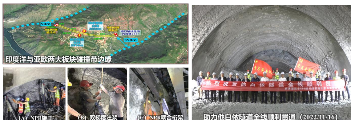
图 10 断层破碎带隧道大变形控制技术助力他白依隧道单洞贯通
